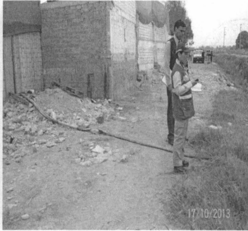
Fotografía 2. Manguera que termina en canal de riego.
