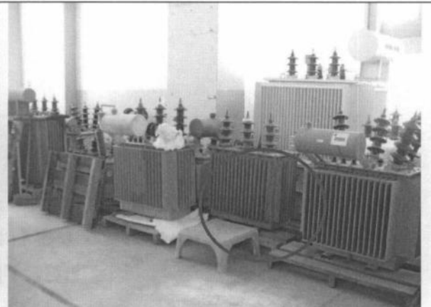
Vista 4 Transformadores para reposición.
