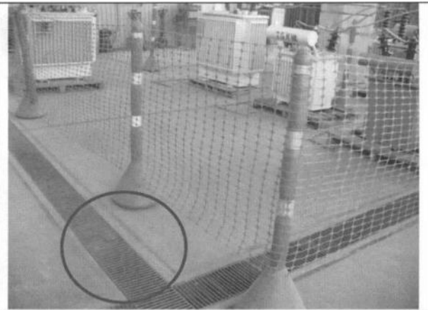
Vista 8 Canaletas para drenaje en caso de derrames de aceites.
