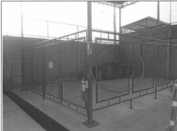
Vista 1 Cerco alrededor de transformadores con PCBs.
