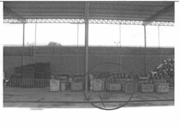
Vista 4 Transformadores sobre piso de concreto.
