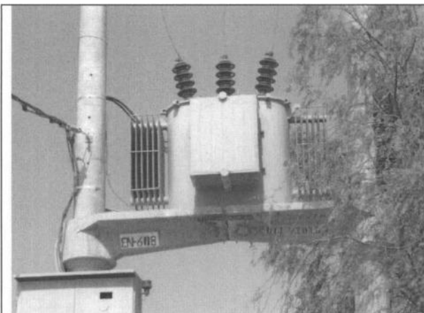
Vista 17 SE EN 608 sin fuga de aceite. Monsefú
