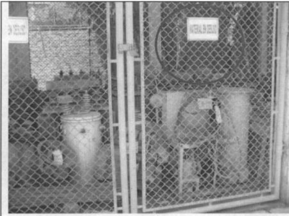
Vista 7 Recinto con transformadores fuera de uso.
