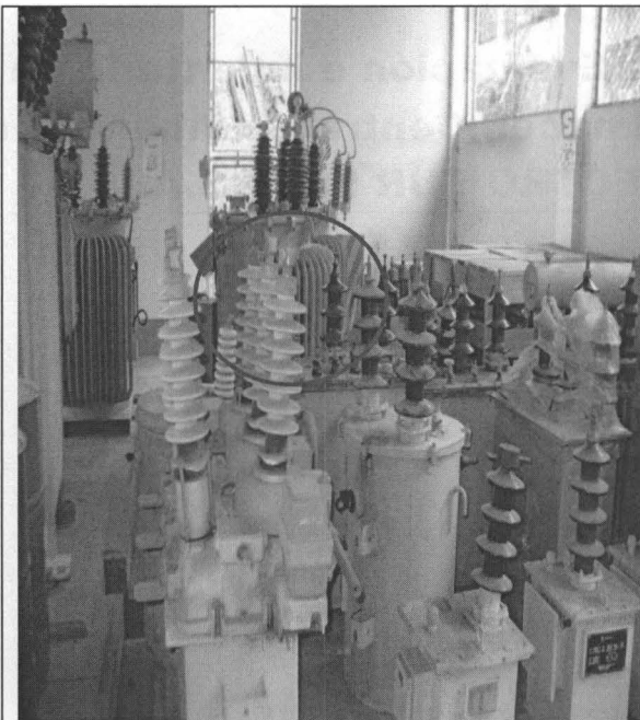
Vista 3 Transformadores nuevos para recambio sin etiquetas de identificación de contenido de PCB.
