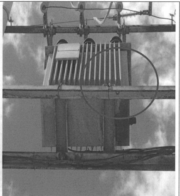
Vista 4 SE sin número, con fuga de aceite en Calle Victoria con Prolongación Huancavelica, Abancay.
