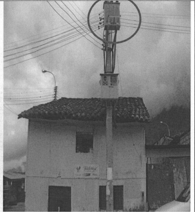
Vista 2 SE 04 sin fuga de aceite. Abancay
