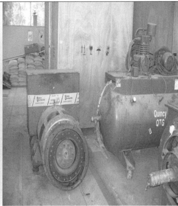
Vista 6 Equipo electromecánico operativo.
