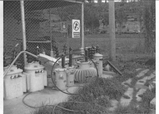
Vista 8 Transformadores nuevos para recambio sin etiquetas de identificación de contenido de PCB.
