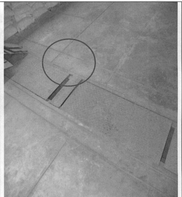
Vista 4 Canaleta para drenaje, en caso de fugas o derrames de líquidos.
