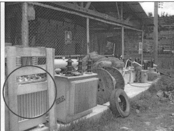
Vista 5 Transformadores nuevos para recambio.
