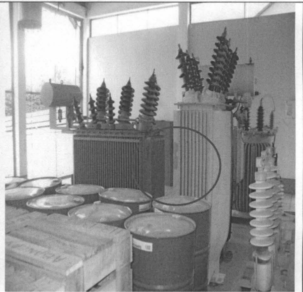
Vista 2 Transformadores de potencia para recambio y cilindros de aceite mineral.
