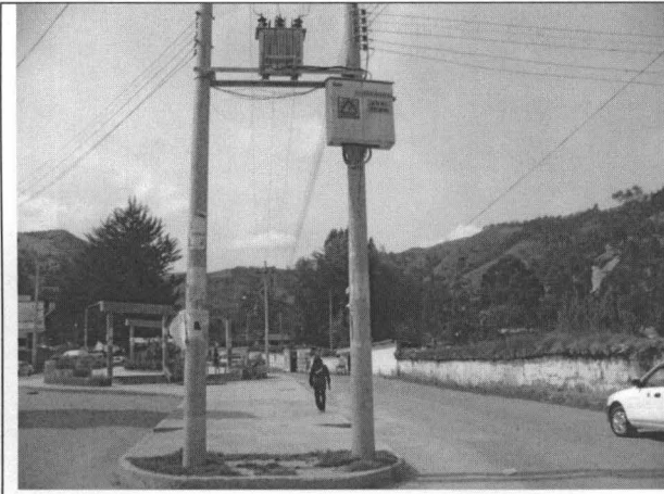
Vista 1 SE 015 sin fuga de aceite. Andahuaylas
