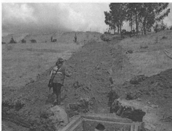
Foto 17: Canal en terreno para captar lixiviados
