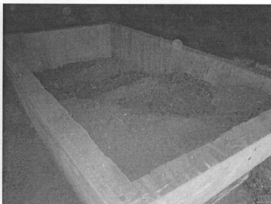
Foto 13: Poza interior donde existen supuestamente residuos hospitalarios enterrados
