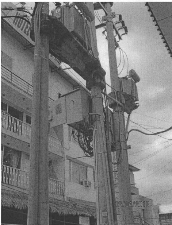
Ilustración 7: Equipo transformador en la vía pública
