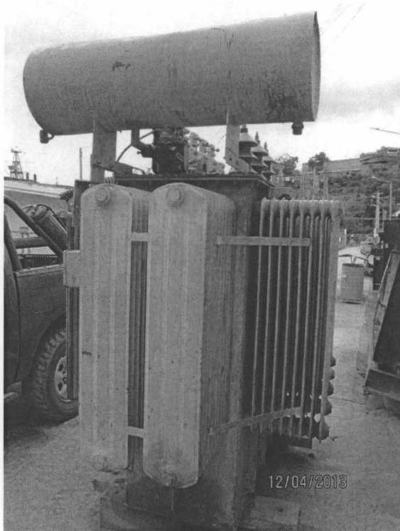
Ilustración 21: transformador en la instalación de generación de ELECTRO ORIENTE S.A. en la Banda de Shilcayo
