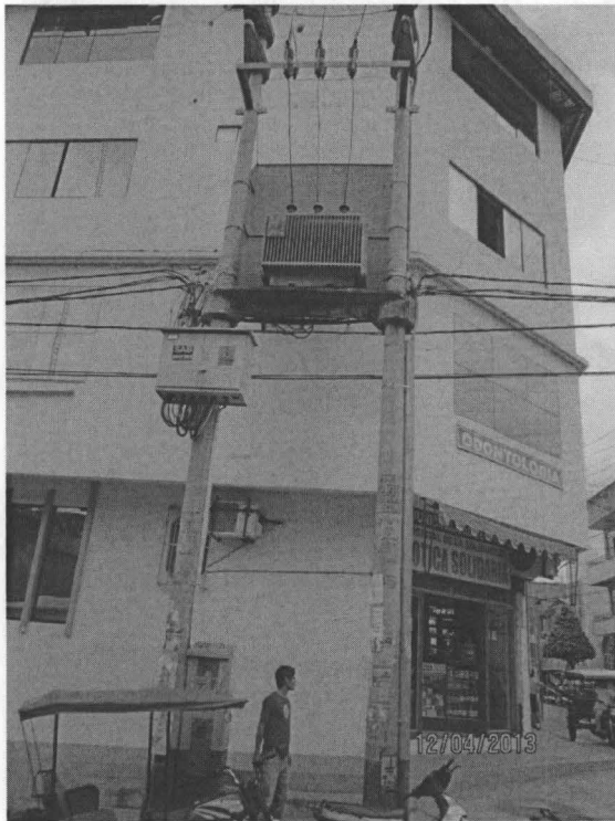
Ilustración 13: Equipo transformador en la vía pública
