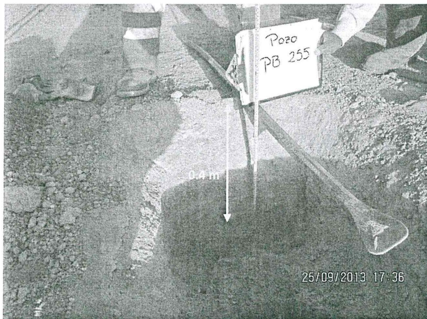
Fotografía N° 6. Punto de monitoreo donde se tomó una (1) muestra para TPH y una (1) muestra para análisis granulométrico en calicata de 0,4 m, es la única donde se encontró rastros organolépticos de suelo con hidrocarburo.
