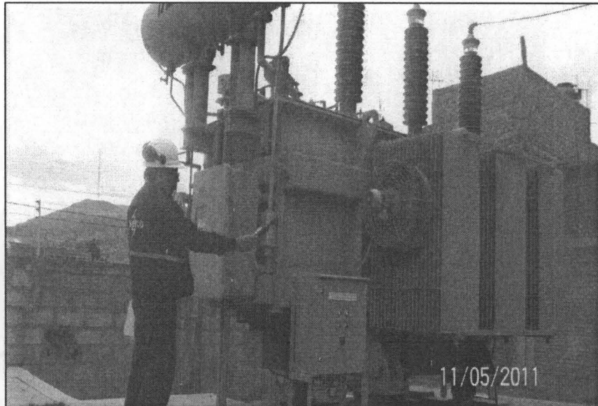
Fotografía N° 3: Medición del nivel de ruidos, realizado en el patio de llaves de la SET Bellavista.
