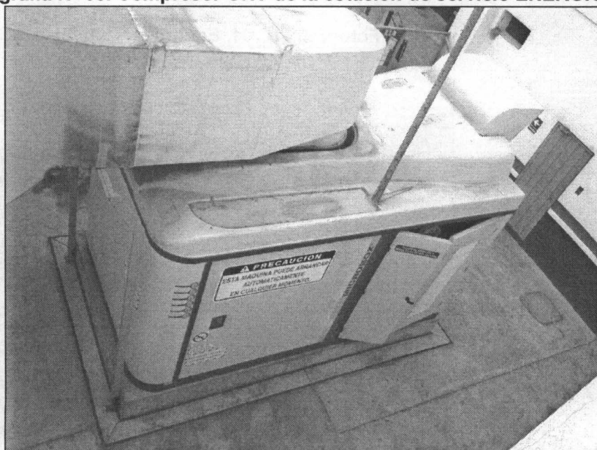
Fotografía N° 03. Compresor GNV de la estación de servicio ENERGIGAS
