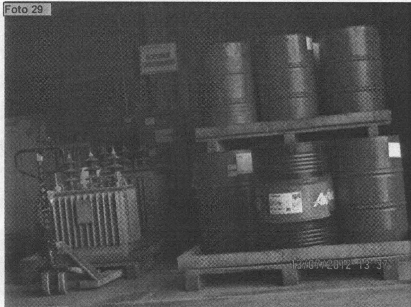
Fotografía N° 29 - Acopio de aceite dieléctrico que será enviado a otra empresa para su regeneración
