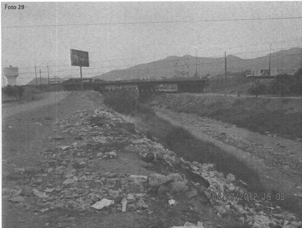
Fotografía N° 29. Vista panorámica del Puente Chillón a la altura del Cruce del Avenida Panamericana con el río Chillón, que evidencia la magnitud del impacto de los residuos sólidos sobre el cauce del río Chillón, en la jurisdicción del distrito de Comas. Coordenadas UTM WGS 84 (18L 0274173E 8681708N)
