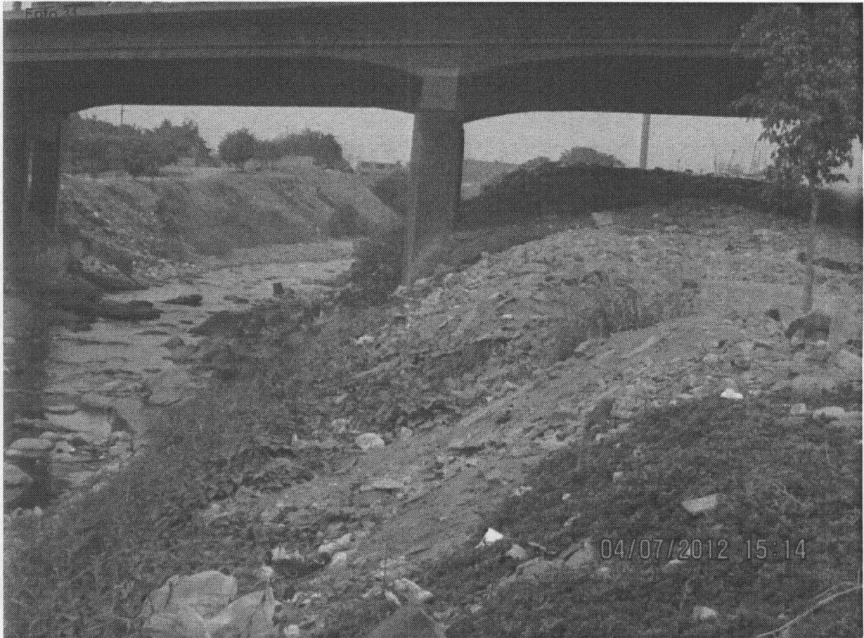
Fotografía N° 31. Evidencia de la magnitud del impacto por residuos sólidos en las partes bajas del Puente Chillón, por donde pasa una vía afirmada que une los distritos de Los Olivos y Comas. Coordenadas UTM WGS 84 (18L 0274173E 8681708N)
