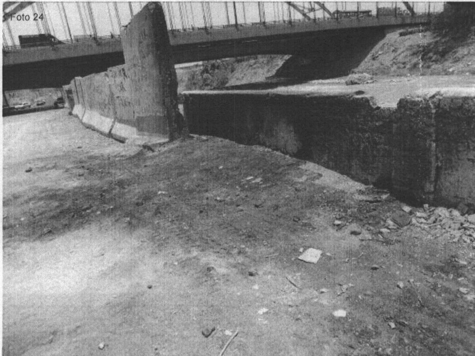
Fotografía N° 24. Evidencia de quema de basura a cielo abierto, en las partes bajas del Puente del Ejercito, sobre el río Rímac, en el punto georeferenciado N° 4, del Cuadro N° 6. Coordenadas UTM WGS 84 (18L 0277570E 8668301N)
