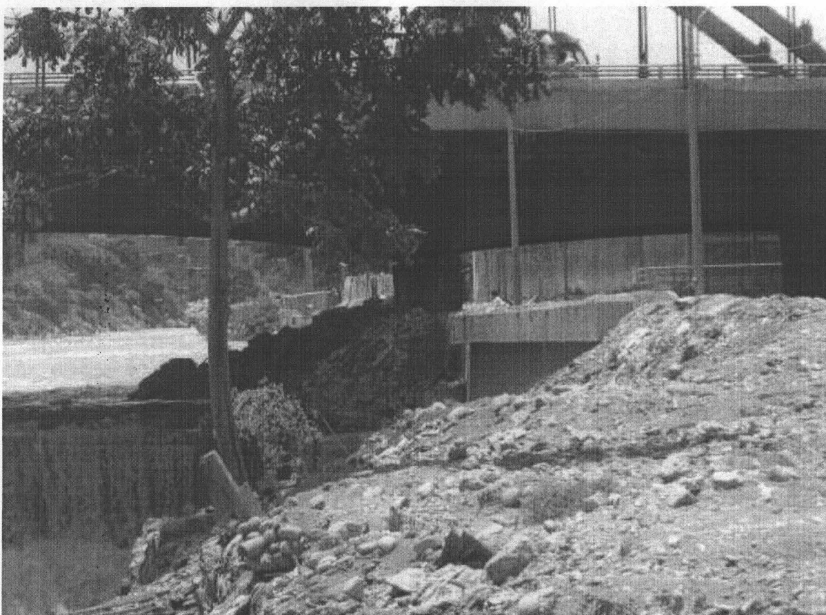
Fotografía N° 22. Evidencia de acumulaciones de residuos sólidos domésticos y de construcción en las partes bajas del Puente del Ejército, sobre el río Rímac, en el punto georeferenciado N° 3, del Cuadro N° 6. Coordenadas UTMWGS 84 (18L 0277522E 8668305N)
