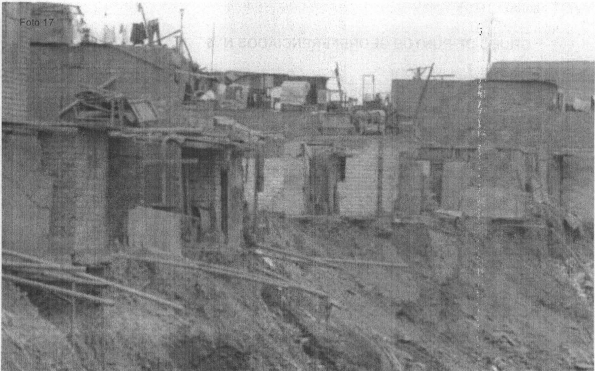
Fotografía N° 17. Evidencia de instalaciones de tuberías de desagüe doméstico con descarga directa al río Rímac, en el punto georeferenciado N° 1, del Cuadro N° 5. Coordenadas UTM WGS 84 (18L 0276813E 8668640N)
