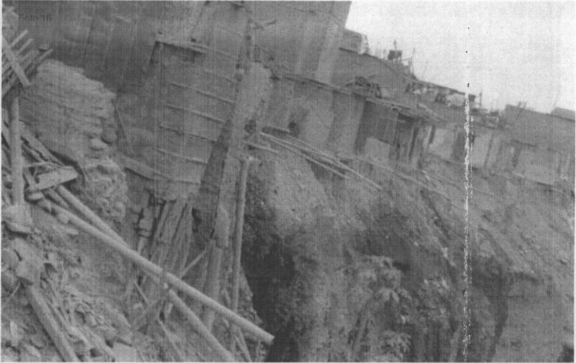
Fotografía N° 16. Evidencia de instalaciones de tuberías de desagüe doméstico con descarga directa al río Rímac, en el punto georeferenciado N° 1, del Cuadro N° 5. Coordenadas UTM WGS 84 (18L 0276813E 8668640N)
