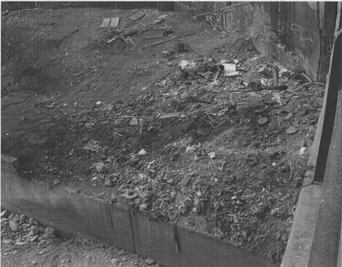
Fotografía N° 31. Evidencia de arrojamiento de residuos sólidos domésticos, en el punto georeferenciado N° 2, del Cuadro N° 8. Coordenadas UTM WGS 84 (18L 0280156E 8667796N)
