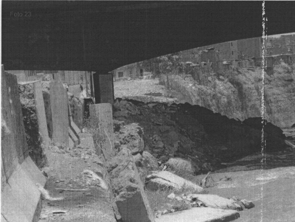
Fotografía N° 23. Evidencia de acumulaciones de residuos sólidos domésticos y de construcción en las partes bajas del Puente del Ejercito, sobre el río Rímac, en el punto georeferenciado N° 3, del Cuadro N° 6. Coordenadas UTM WGS 84 (18L 0277522E 8668305N)
