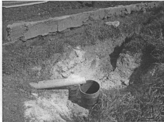
Foto 22: Sistema de drenaje de la planta de tratamiento
