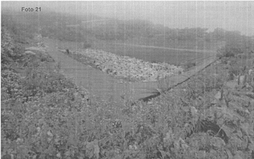
Fotografía N° 21. Evidencia del grado de acumulación de residuos sólidos, en las pozas impermeabilizadas, en el punto georeferenciado N° 1, del Cuadro N° 5. Coordenadas UTM WGS 84 (18L 327785E 8738519N)
