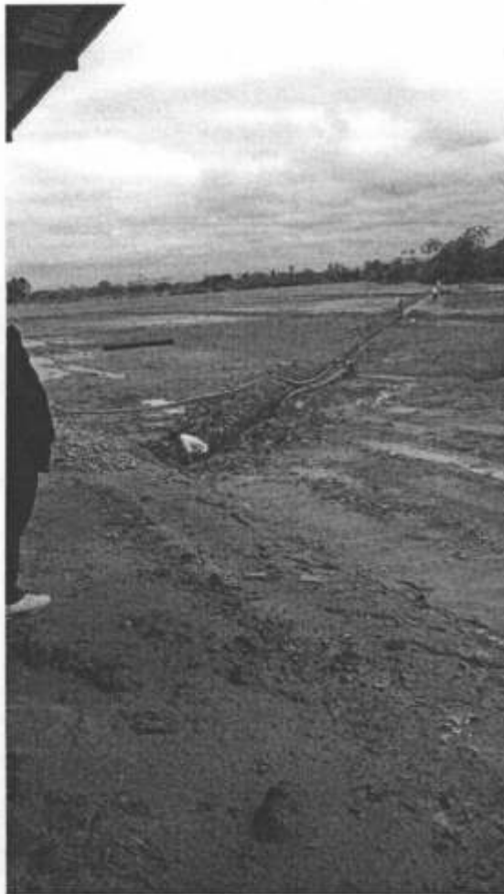
Foto 30: Implementación de los canales de lixiviados en el fondo de la infraestructura para la conexión con la balsa de lixiviados a la izquierda de la toma fotográfica
