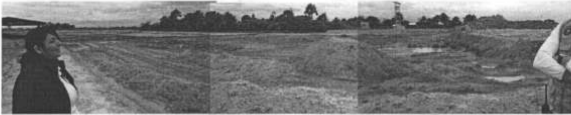
Foto 29: Infraestructura para el proyecto de relleno, de 300 x 100 m aproximadamente. En el extremo izquierdo se aprecia la balsa de lixiviados techada, al fondo en la izquierda parte del lecho del relleno implementada con geo malla; a la derecha el terreno sin nivelar ni compactar, al fondo las instalaciones de administración. El lado del relleno que da hacia los árboles no cuenta con talud de contención.
