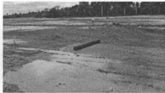
Foto 31: Sector del relleno que se encuentra implementada con geo malla y sobre la que esta creciendo vegetación. Al fondo se observa la falta del talud de contención
