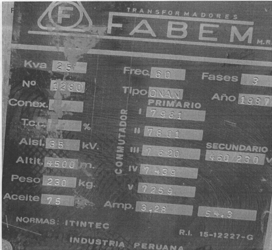
Fotografía N° 17. Evaluación de la placa del transformador eléctrico de Serie N° 1280. (Datos de Potencia, Peso y tipo de aceite, año de fabricación y peso bruto del equipo), en los almacenes de la empresa Electrocentro S.A. De la ciudad de Cerro de Pasco. Coordenadas UTM WGS 84 (18L 362455E 8820452N)
