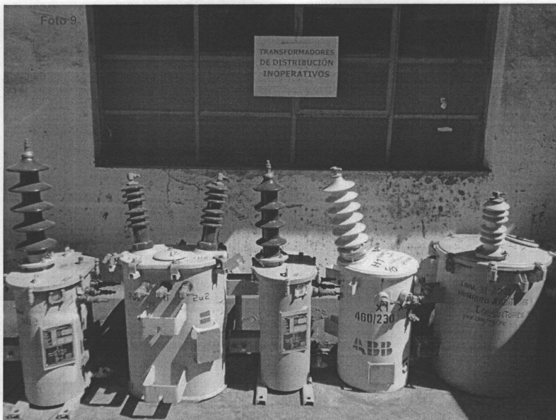
Fotografía N° 9. Evidencia del proceso de evaluación en campo del inventario de transformadores eléctricos de distribución inoperativos en los almacenes de la empresa Electrocentro S.A. Coordenadas UTM WGS 84 (18L 362456E 8820458N)
