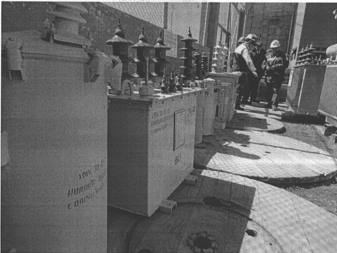
Fotografía N° 7. Evidencia del tipo de almacenamiento al aire libre de transformadores eléctricos de distribución operativos e inoperativos en los almacenes de la empresa Electrocentro S.A. Coordenadas UTM WGS 84 (18L 362456E 8820458N)
