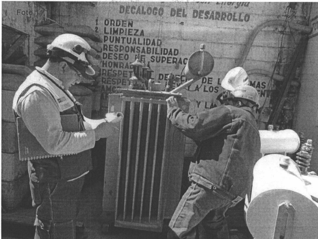
Fotografía N° 11. Evidencia del proceso de evaluación en campo del inventario de transformadores eléctricos de distribución inoperativos en los almacenes de la empresa Electrocentro S.A. Coordenadas UTM WGS 84 (18L 362455E 8820452N)
