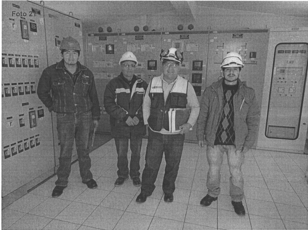
Fotografía N° 21. Evidencia de la visita a las instalaciones de la sala de control de la Sub Estación Pasco, ubicado en las afueras de la ciudad de Cerro de Pasco, por del lado Oeste. Coordenadas UTM WGS 84 (18L 360429E 8820987N)
