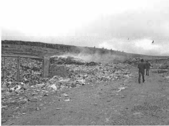
Foto 7: Ingreso al sitio de disposición a través de una parte derrumbada del cerco
