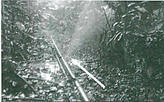
Corte del Oleoducto en el KP 9 + 397 Oleoducto Chambira - Corrientes
