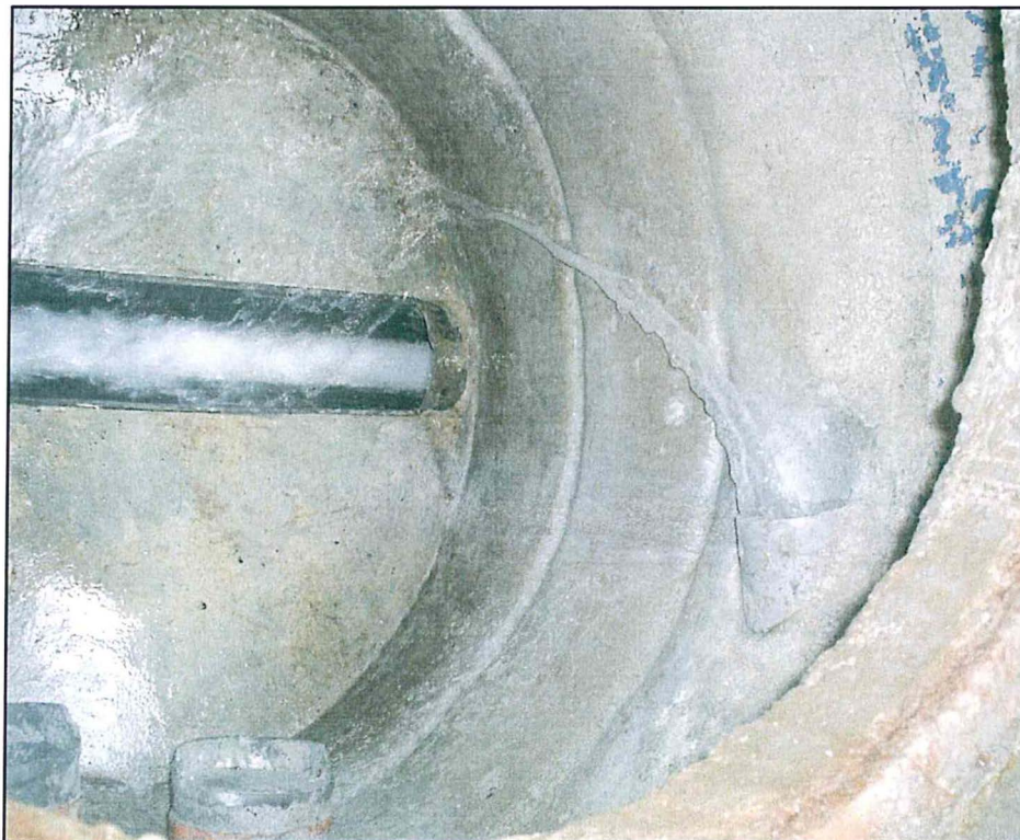
Fotografía N° 2. Punto de monitoreo "E-1" (después de la etapa de tratamiento).
