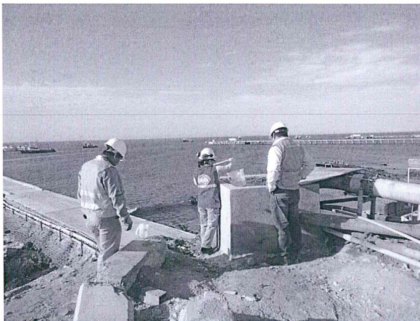
Fotografía 2. Toma de muestra del efluente, punto de muestreo E-2. Caja de registro posterior al sistema de tratamiento de efluentes de la planta de congelado y planta de harina residual. Industrial Pesquera Santa Mónica S.A.
