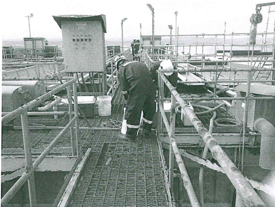
Fotografía N° 2: Planta de tratamiento de efluentes líquidos de la empresa Perú LNG
