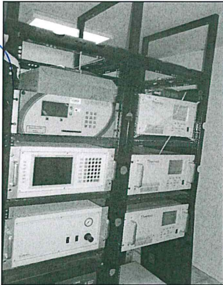
Fotografía N°03. Equipos analizadores de gases
