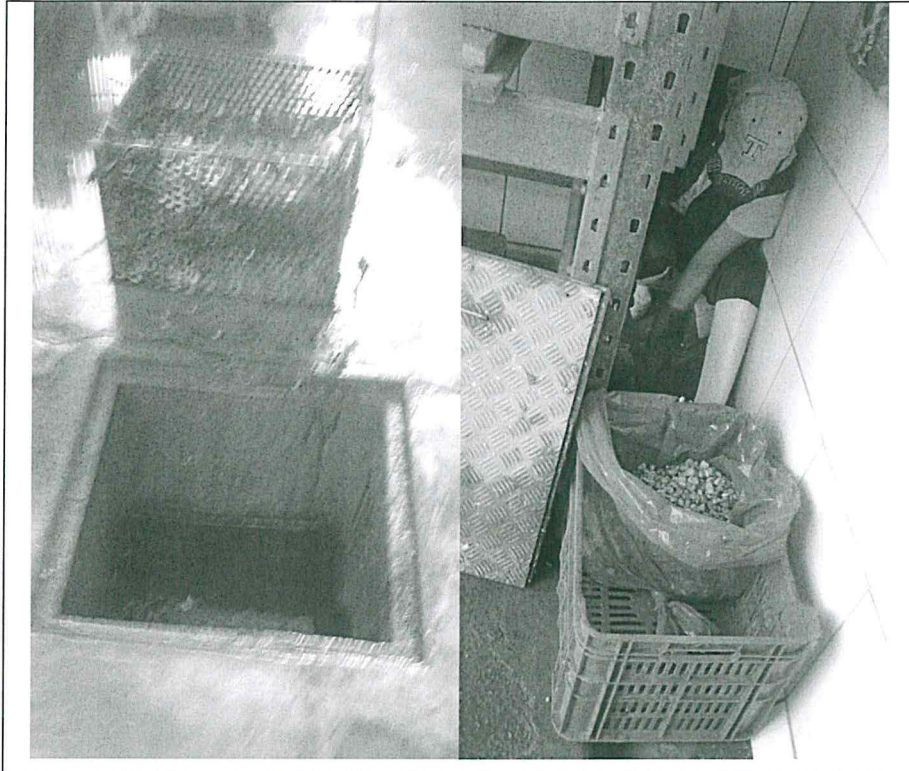
Fotografía 01. Cámaras de sedimentación colmatada de granos de maíz, restos de vainitas, y otros. Empresa AGROHIDRO EIRL. 26 Set. 2013.
