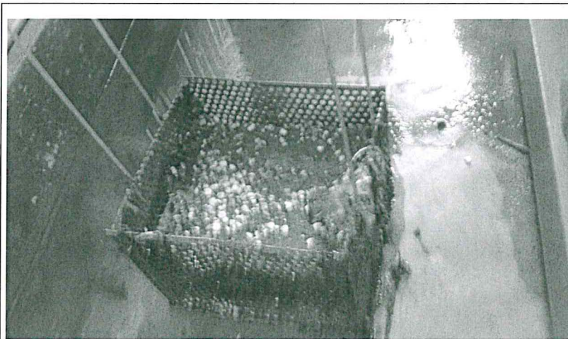
Fotografía N° 02. Canastillo de acero inoxidable instalado en las cámaras con material retenido (granos de maíz y otros) que no al no ser removido oportunamente por rebose los materiales pasan a la red pública. AGROHIDRO E.I.R.L 26 de Set. 2013
