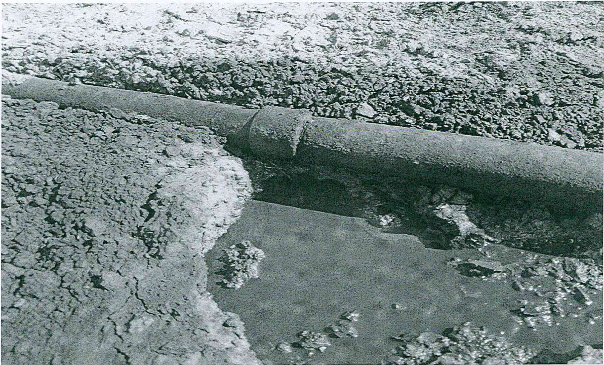
Fotografía N° 5. Vista del suelo impregnado con hidrocarburo producto de liqueo de tubería.
