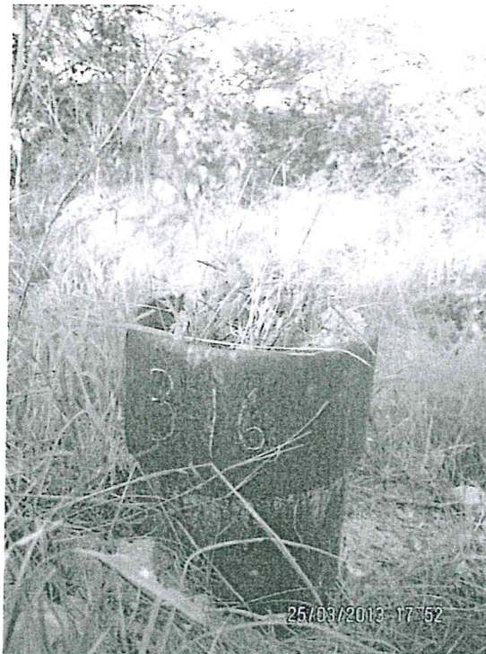
Fotografía N° 2. Se ubicó casing a nivel de superficie, sobresale 0,40 m, no presenta señalización.
