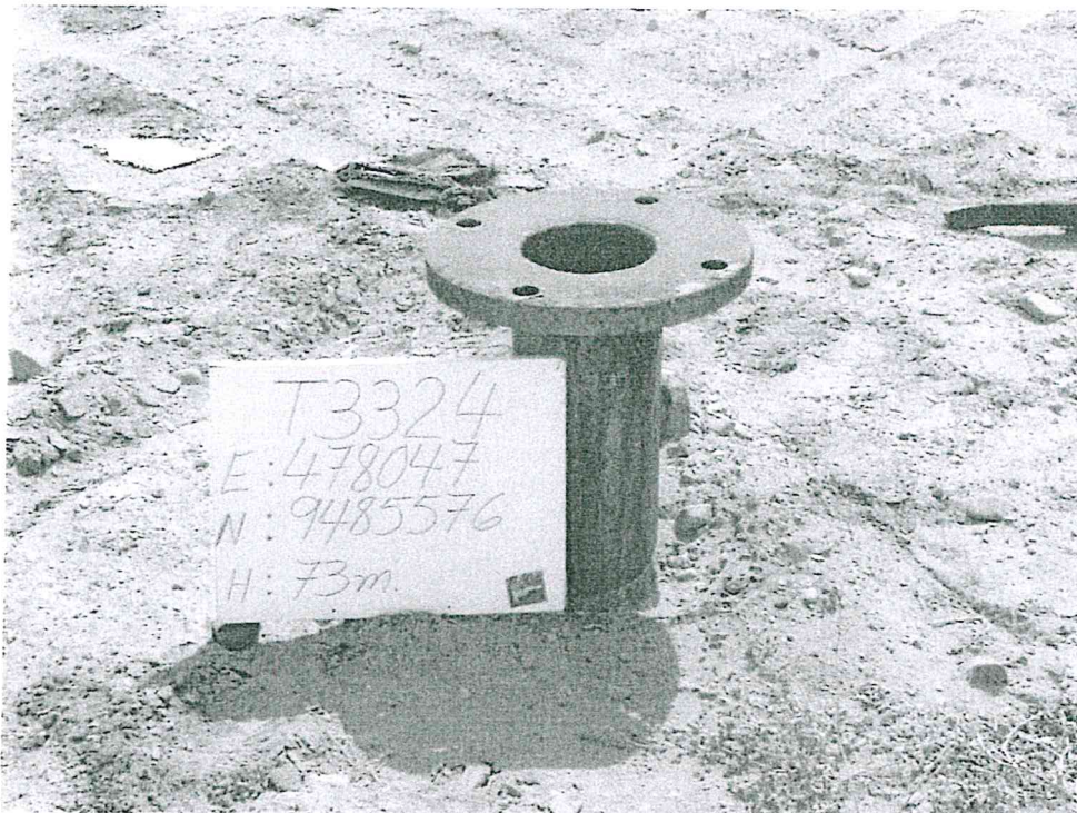
Fotografía N° 1. Pozo mal abandonado con código T3324, con casing y brida, no sellado herméticamente.
