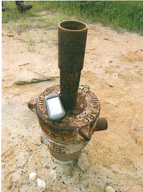
Fotografía N° 2. Pozo inactivo, presenta casing y reducción parcialmente oxidados de 0,5 m sobre la superficie del suelo, no se evidencia residuos de hidrocarburo en el suelo ni se percibe organolépticamente olor característico a hidrocarburo.
