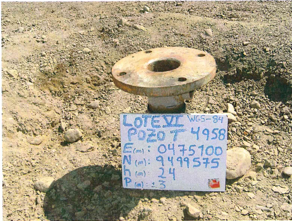
Fotografía N° 1. Se observa pozo mal abandonado con casing sin tapón y expuesto al aire libre.
