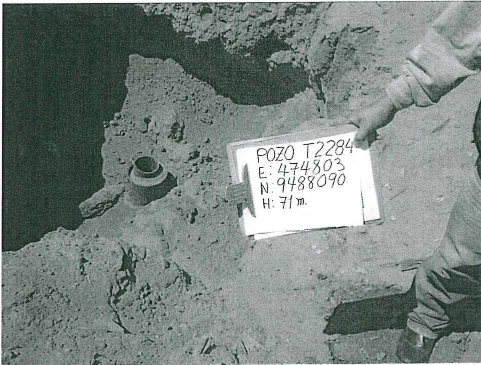
Fotografía N° 1. Pozo T2284 mal abandonado, sin cabezal, con casing de superficie y tubo interior corroído.
