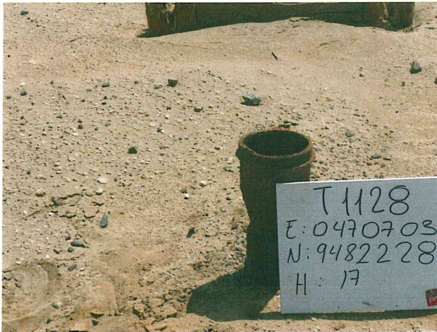
Fotografía N° 1. Pozo mal abandonado con código PERUPETRO T1128, sin cabezal, con tubo expuesto 0,33 m aproximadamente sobre el nivel del suelo, el pozo no está sellado herméticamente.
