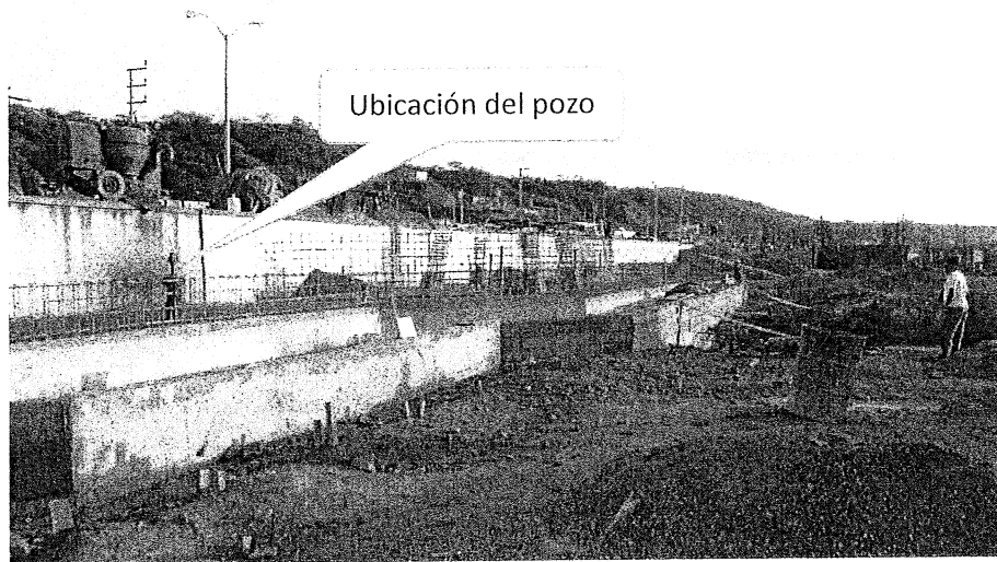
Fotografía N° 1. Ubicación del pozo mal abandonado ubicado en una pileta en la zona de construcción del malecón, de la obra denominada "Mejoramiento y Desarrollo Turístico del Malecón Zorritos".
