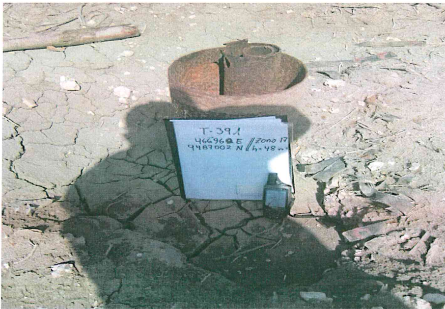
Fotografía N° 2. Vista del casing y tubo interior del pozo corroído por el óxido.
