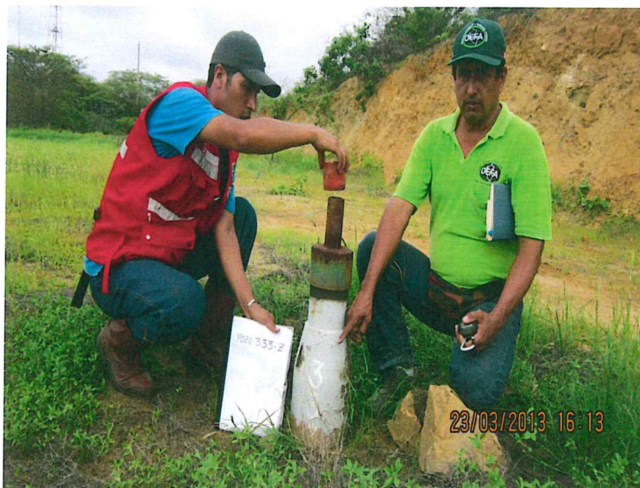
Fotografía N° 2. Se observa pozo inactivo, con casing que sobresale 0,5 m sobre el nivel del suelo, sin cabezal ni válvulas que aseguren su hermetismo.
