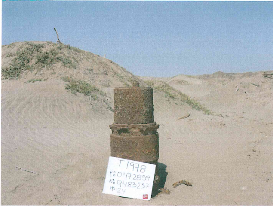
Fotografía N° 1. Pozo inactivo, sin cabezal, con casing y extensión de tubo corroído que sobresale aproximadamente 0,85 m sobre el nivel del suelo.
