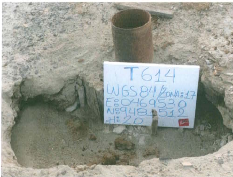
Fotografía N° 1. Pozo inactivo mal abandonado, sin cabezal, se observa tubo expuesto corroído.
