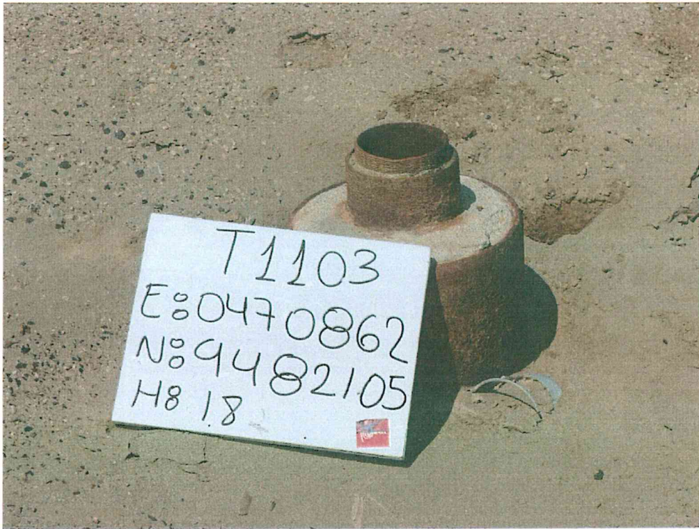
Fotografía N° 1. Pozo con código PERUPETRO T1103 inactivo mal abandonado, sin cabezal con casing cementado y tubo interior corroído de 0,31 m sobre el nivel del terreno.
