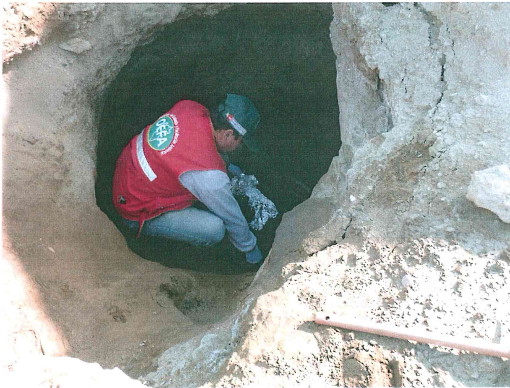
Fotografía N° 3. Toma de muestra de suelo contaminado con hidrocarburo en el pozo T_574.
