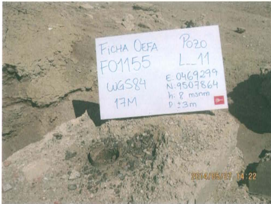
Fotografía N° 1. Pozo inactivo L__11, con casing corroído, cementado y rodeado por una base de concreto.
