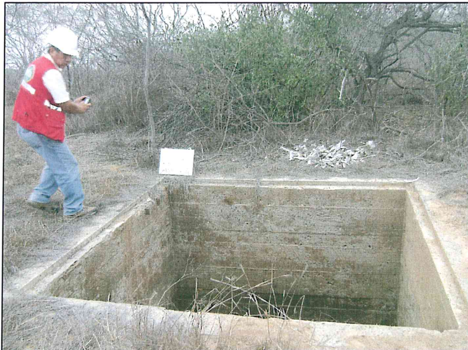
Fotografía N° 2. Se observa la cantina que no ha sido rellenada ni nivelada al terreno circundante.
