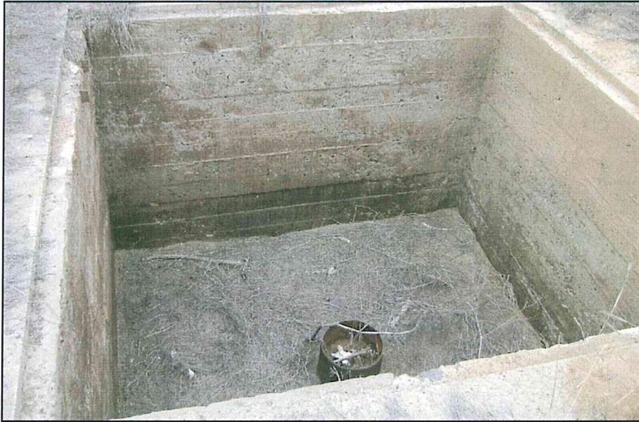
Fotografía N° 1. Pozo inactivo cuyo casing está cubierto de tierra, al fondo de una poza de cemento (cantina) de 2,5 m x 2,5 m x 1,6 m de profundidad.
