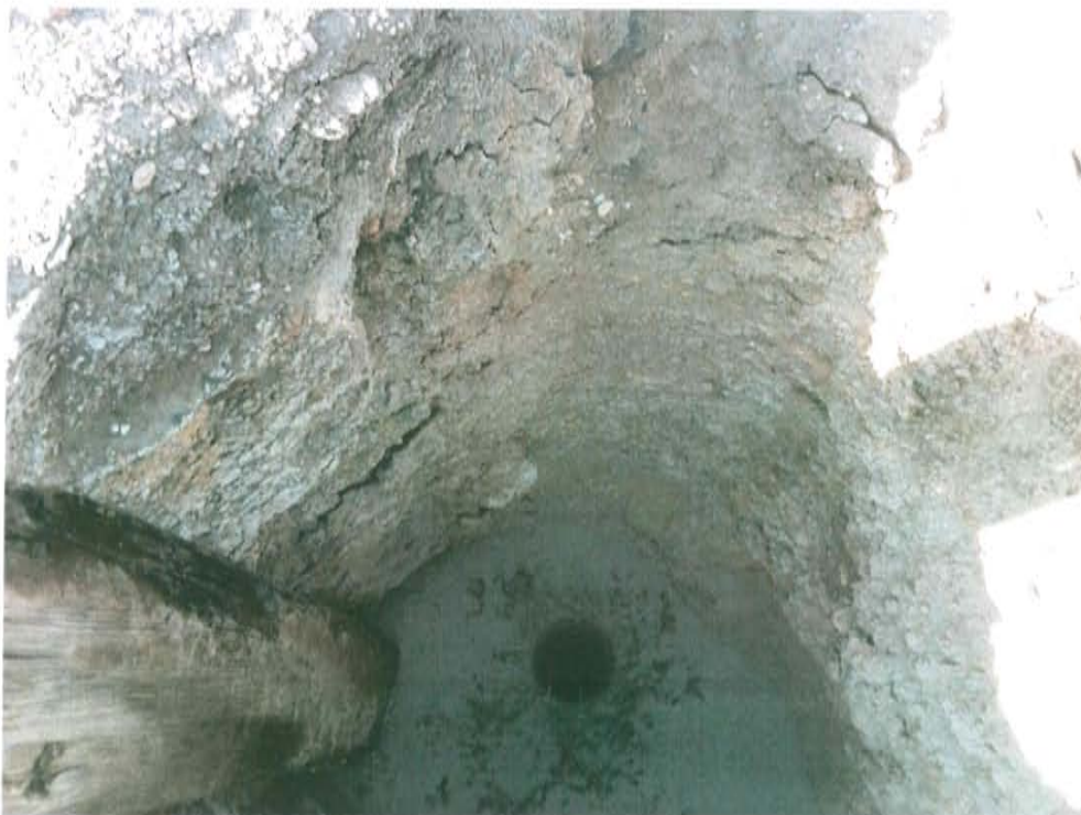
Fotografía N° 2. Pozo T_434 inactivo mal abandonado, se visualiza el casing sin cabezal, ni válvulas que aseguren el hermetismo.
