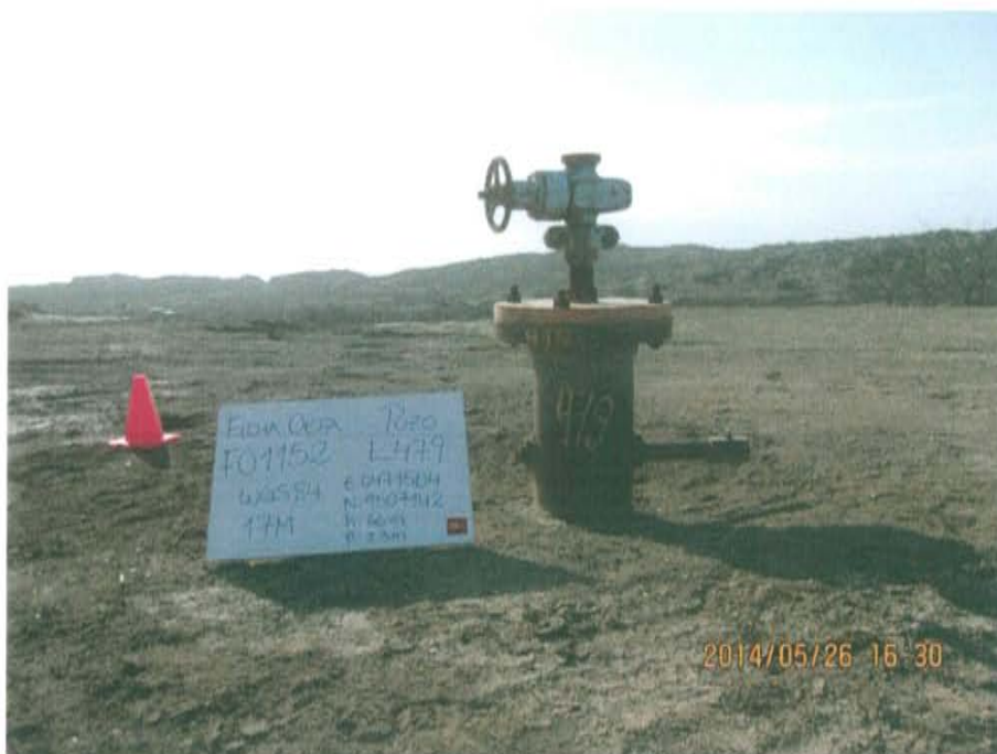
Fotografía N° 1. Pozo L_479, presenta casing con brida, con parte de cabezal y válvulas.
