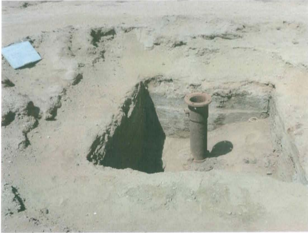
Fotografía N° 1. Identificación del pozo inactivo con código PERUPETRO T2788, presenta casing sin brida y sin válvulas que aseguren su hermetismo.
