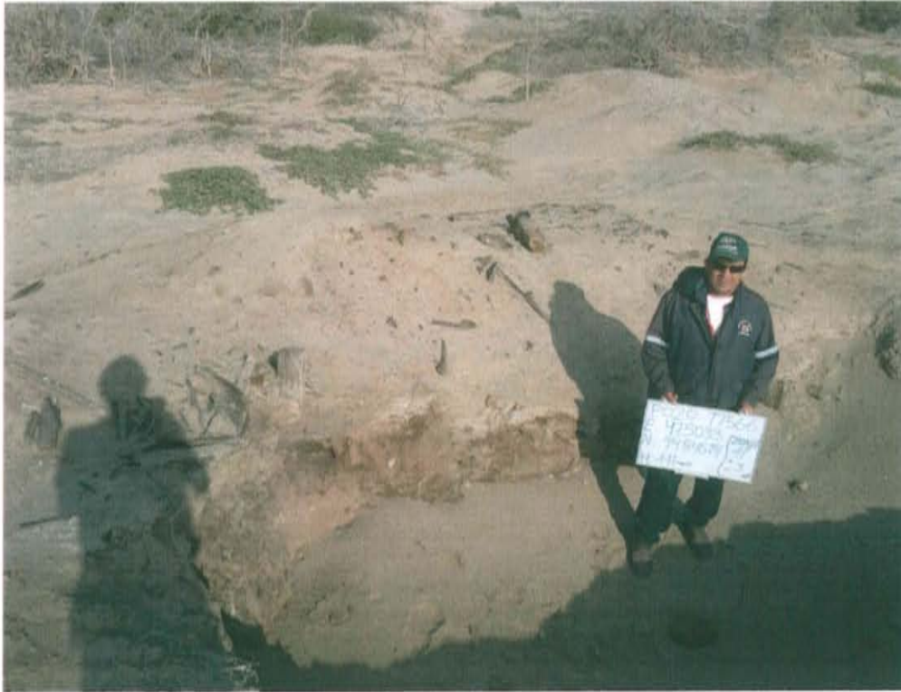
Fotografía N° 1. Identificación del pozo inactivo con código PERUPETRO T1566. Presenta casing sin válvulas que aseguren su hermetismo.
