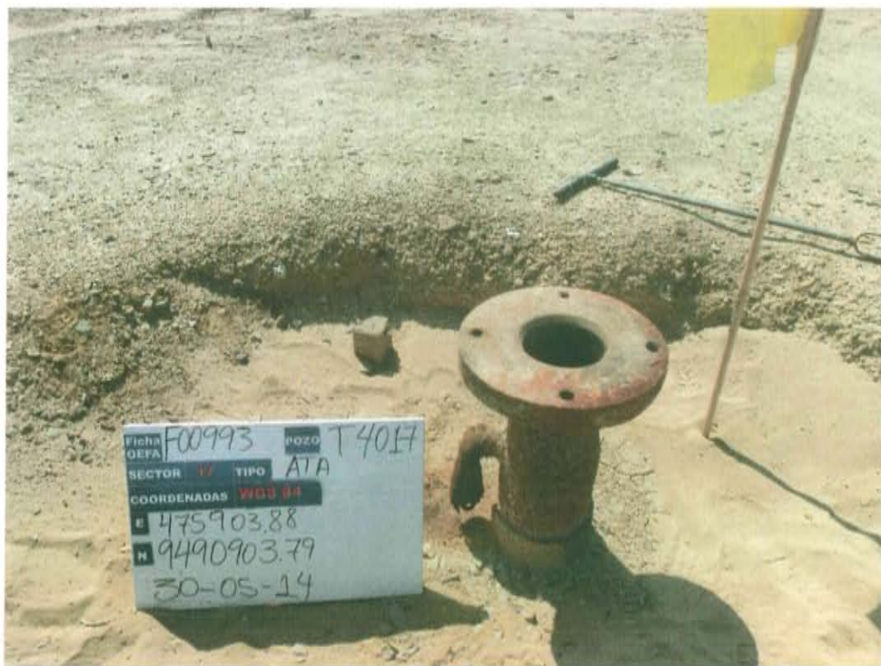
Fotografía N° 1. Pozo T4017, se observa casing de 8 pulgadas aproximadamente, con brida pero sin ningún elemento de cierre que asegure su hermetismo.
