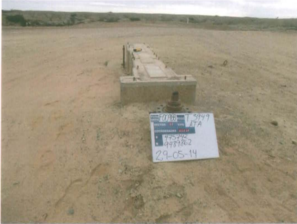
Fotografía N° 3. Adyacente al Pozo T3949, se observó una base de concreto (soporte de equipo de extracción mecánica de petróleo crudo).
