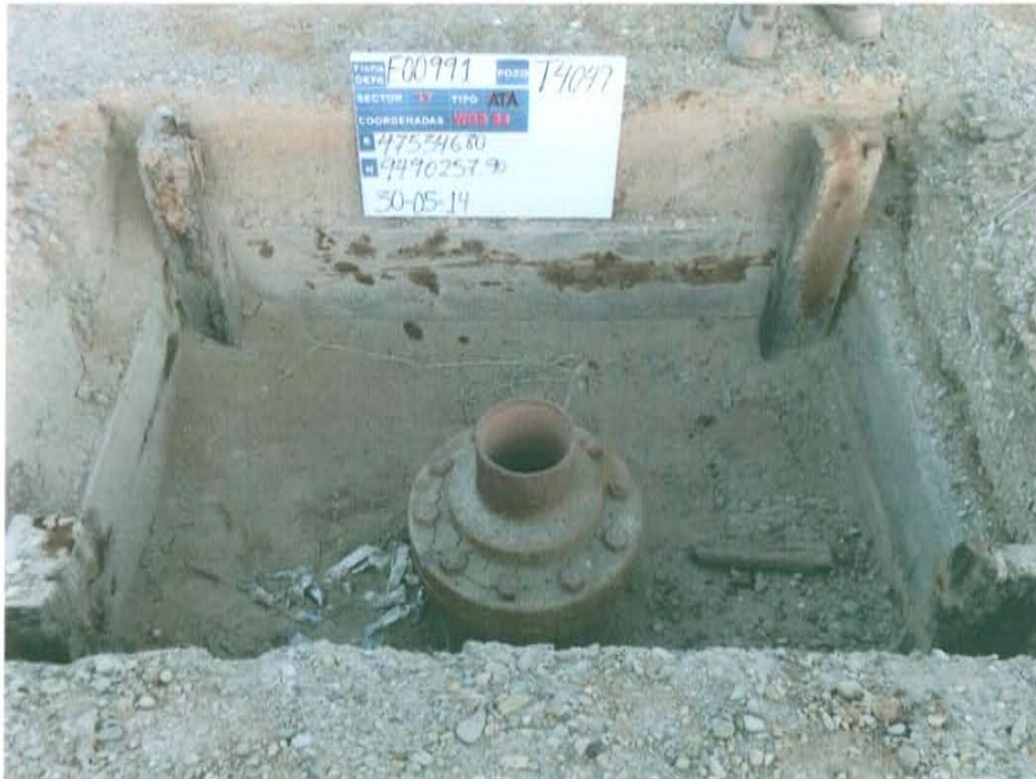
Fotografía N° 1. Pozo T4049, se observa casing abierto de de 5 pulgadas aproximadamente.
