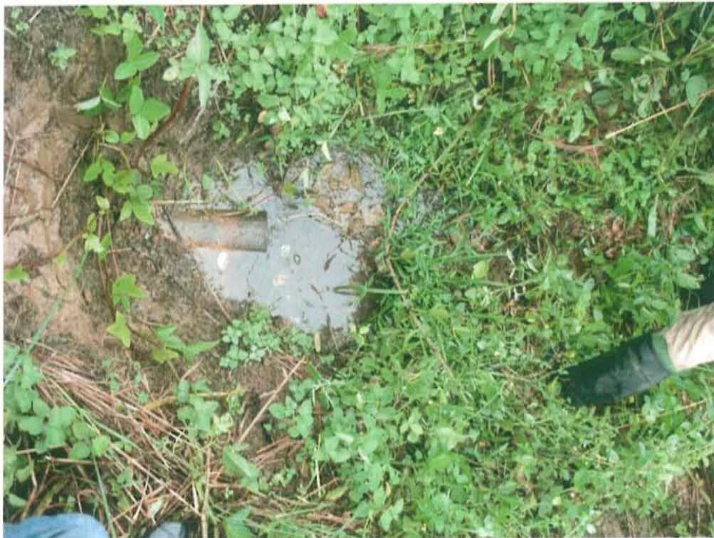
Fotografía N° 4. Restos de tuberías en desuso perteneciente al campamento mal abandonado.
