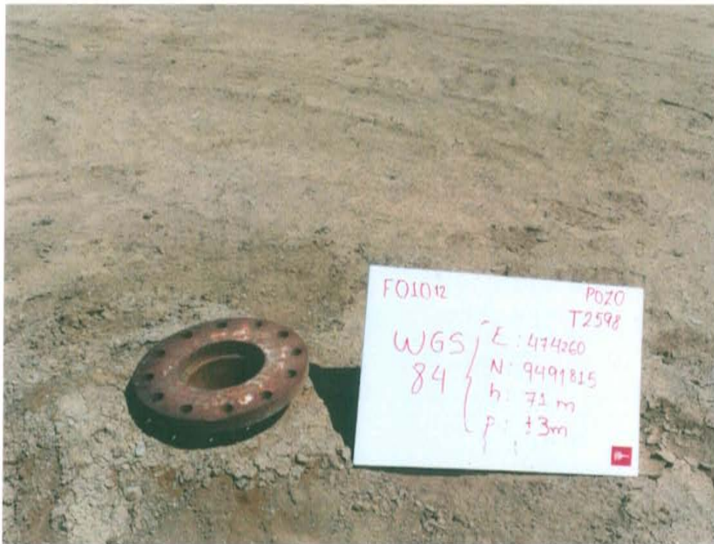
Fotografía N° 1. Identificación del pozo inactivo con código PERUPETRO T2598, en estado corrosivo y con brida.
