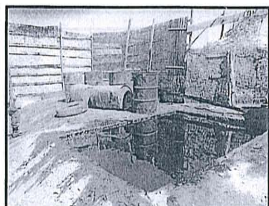
Foto 22: Poza con contenido de crudo de concreto.
