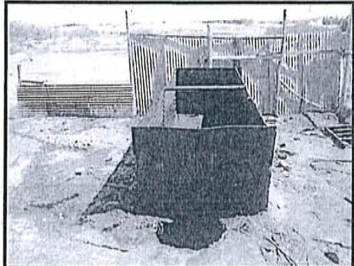
Foto 18: Equipo de depósito de crudo vacío y suelo alrededor del mismo afectado por crudo.
