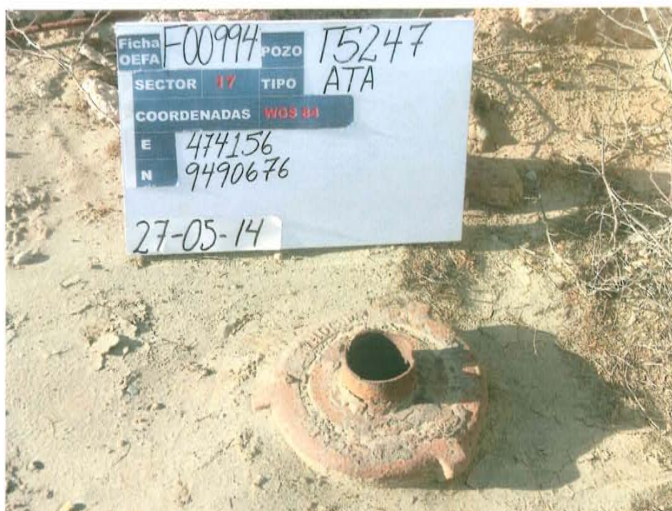
Fotografía N° 1. Pozo T5247, se observa tubing de 4 pulgadas abierto sin ningún elemento de cierre.
