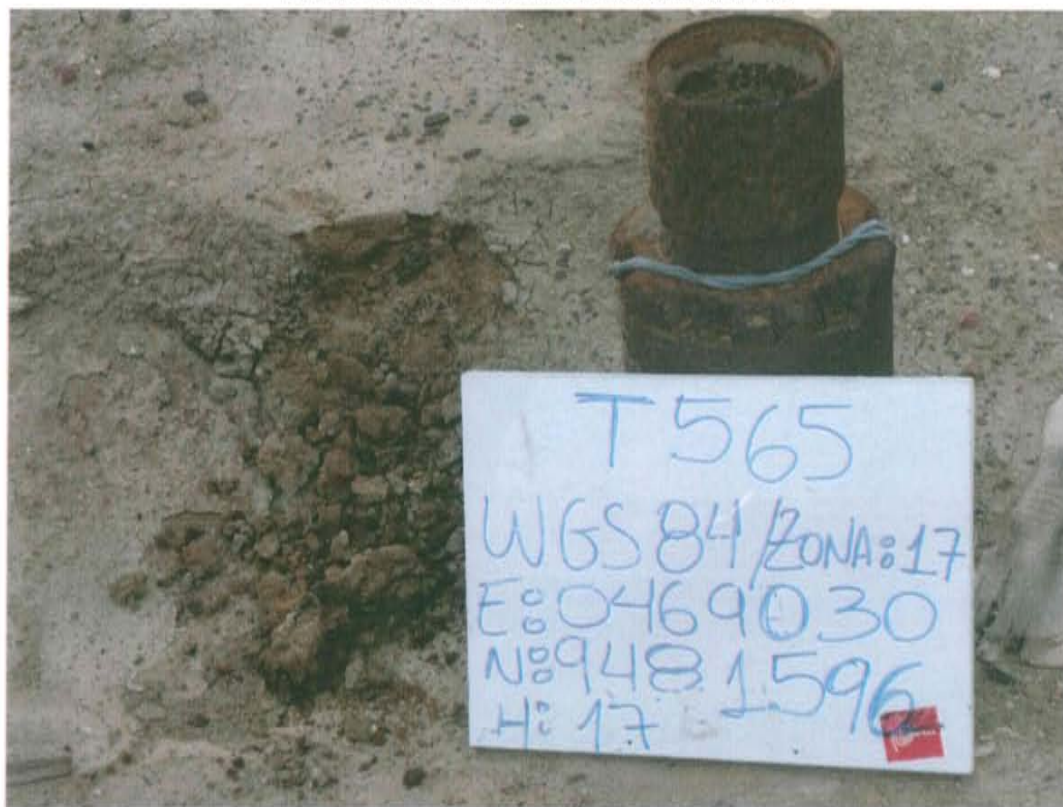
Fotografía N° 1. Vista del Pozo T_565, presenta casing corroído sin cabezal ni válvulas.
